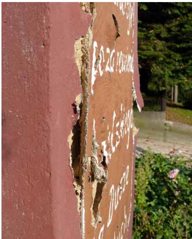
Fig. 17. Piaskowiec pokryty farbą, która łuszczy się wraz z jego fragmentami. Obiekt na Grabówkach, fot. M. Schuster • Sandstone covered with paint that comes off with stone fragments. The wayside shrine in Grabówki, phot. M. Schuster
