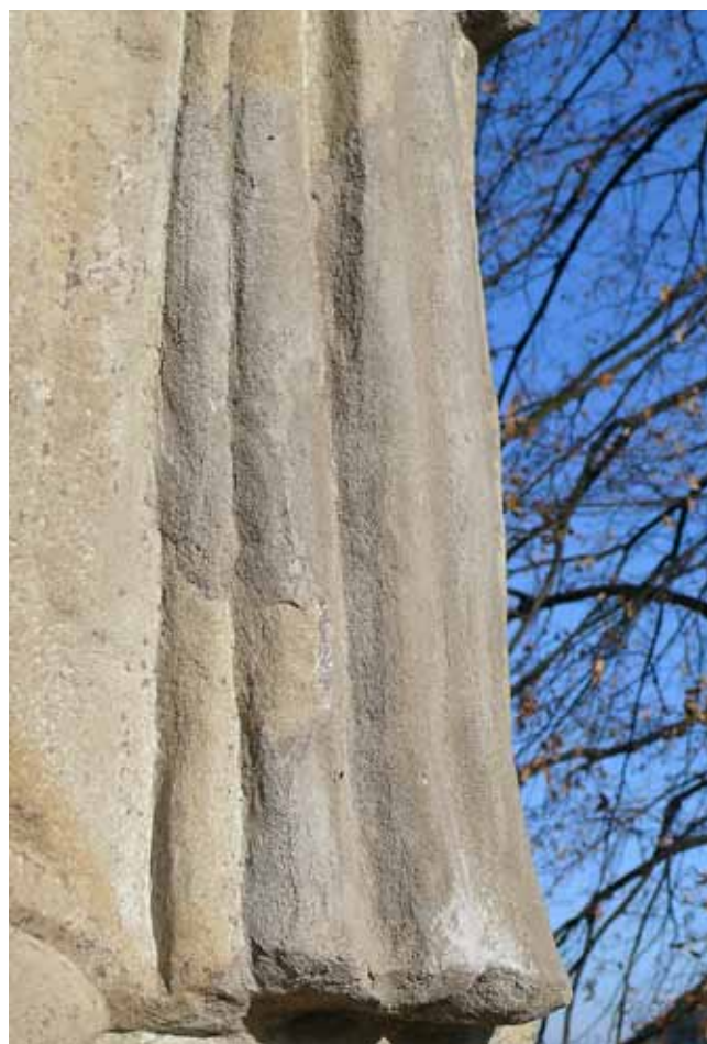
Fig. 27. Ubytki w piaskowcu uzupełnione zaprawą cementowo – wapienną, fot. M. Schuster • Stone cavities filled with cement-lime mortar, phot. M. Schuster
