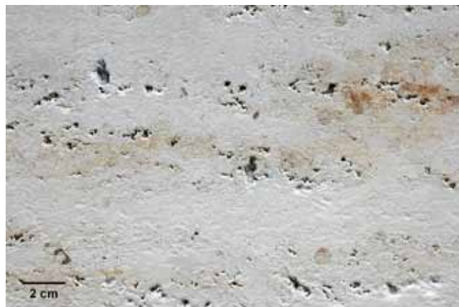
Fig. 15. Wapień Jura Travertino o fakturze antykowanej – elewacja zewnętrzna Restauracji Carlito, fot. Z. Górny • The Jura Travertino limestone with antiquated texture – front elevation of the Carlito Restaurant, phot. Z. Górny
