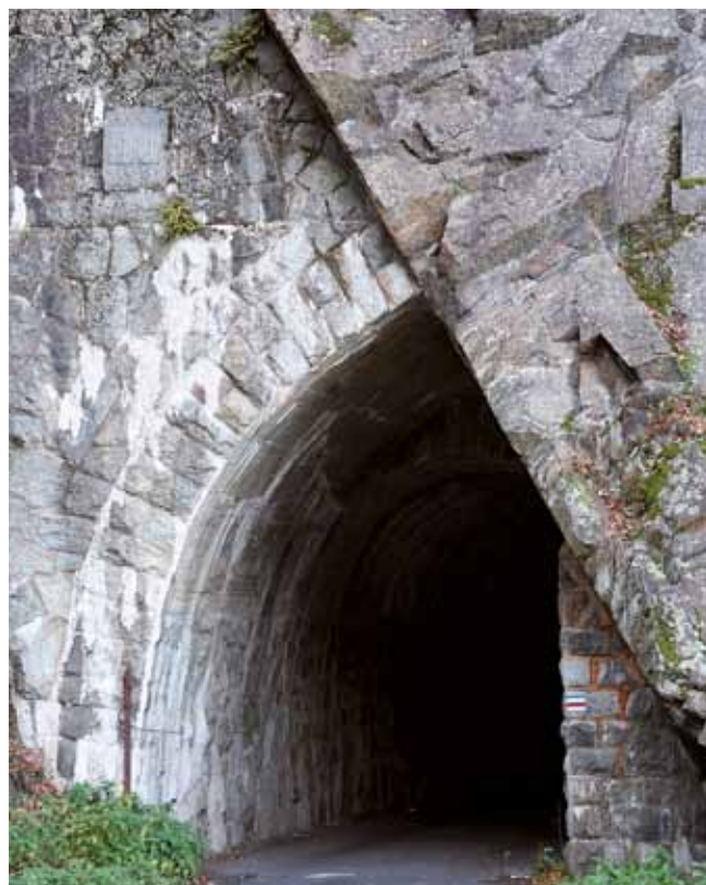
Fig. 11. Tunel wydrążony w gnejsach izerskich, wykorzystujący naturalne powierzchnie ciosowe, prowadzący do Zapory Złotnickiej (OGT 4), fot. M. Łodziński • Tunnel cut in the Izera Gneisses using the joint system, road to the Złotniki dam (OGT 4), phot. M. Łodziński
