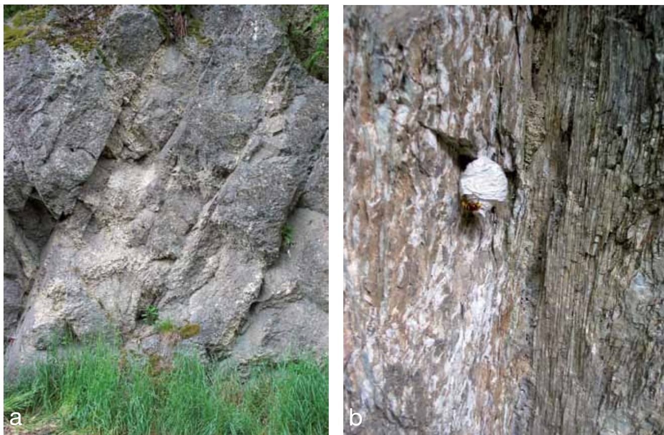
Fig. 18. Przykład przeobrażeń dyslokacyjnych w ścianie gnejsowej przy zaporze Bobrowice-II nad Jeziorem Modrym: a) system spękań kompresyjnych kompleksu gnejsowego, b) strefa zmieniona przez przeobrażenia dyslokacyjne w obrębie kompleksu gnejsowego, fot. M. Stefaniuk • Examples of dislocations in the gneiss wall at the Bobrowice-II dam (the Blue Lake): a) system of compressional joints in gneiss complex, b) zone altered by dislocations in gneiss complex, phot. M. Stefaniuk
