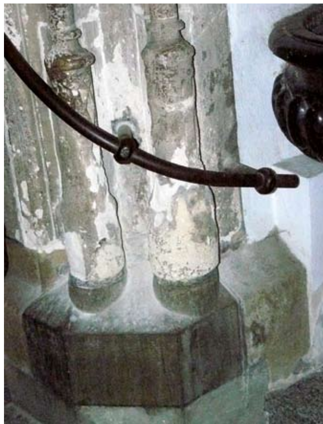
Fig. 5. Liczne ubytki w wapieniu pińczowskim w dolnych częściach portalu, fot. B. Wójcik • Numerous losses of the Pińczów limestone in lower parts of a portal, phot. B. Wójcik
