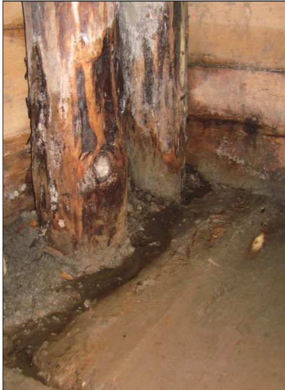
Fig. 4. Przecieki poza ujęcia wycieków WI-36 i WI-37 we wschodniej końcówce chodnika Taras Gór Wschodnich (fot. J. Przybyło 2010)
