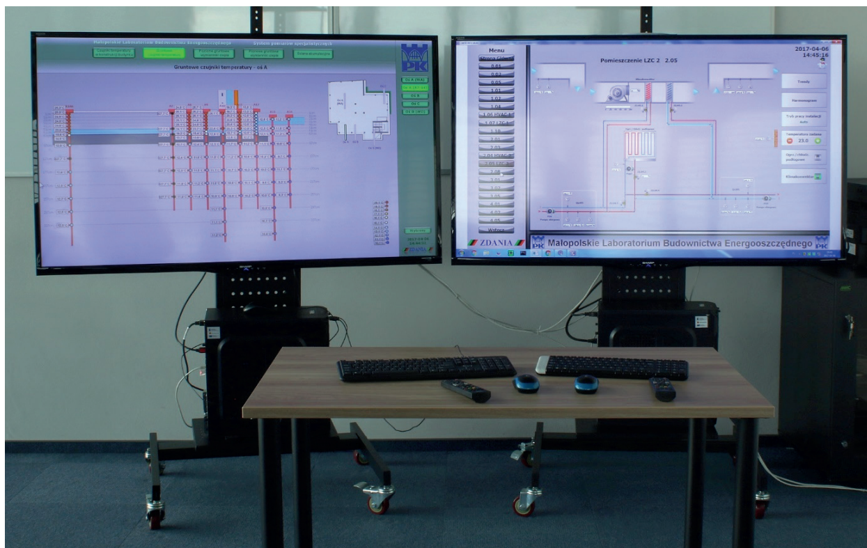
Rys. 2. Stacje operatorские integrated system SSO (z lewej – widok opomiarowania gruntu pod budynkiem) i BBMS (z prawej – widok jednej z pomieszczeniowych instalacji HVAC)
