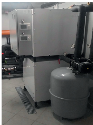
Rys. 6. Pompa ciepła OILON RE 76 umieszczona na instalacji demonstracyjnej w Krakowie
