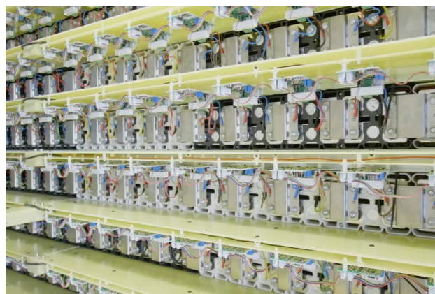
Rys. 2. Baterie litowo-jonowe zamontowane w jednym z kontenerów (źródło: materiały PKP Energetyka S.A.)
